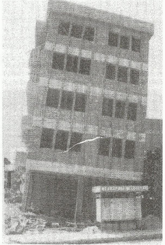
Resim: 6 Yerin alüvyon olması nedeniyle bina dönmüş
