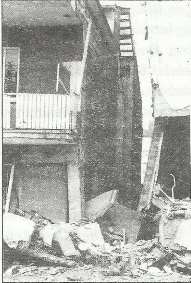
Erzincan 92 - Bitişik nizam iki yapıda deformasyonu
