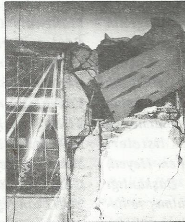
Erzincan 92 - Yumuşak kat deformasyon örneği
