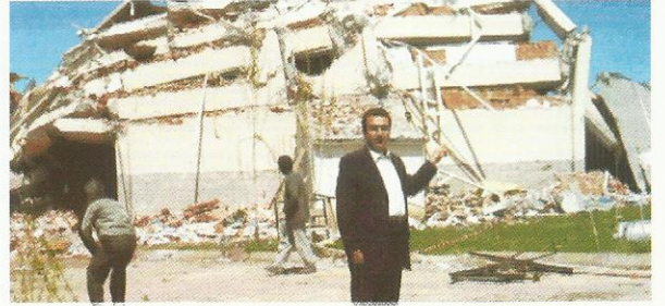
Resim 1: Basit Malzeme kusurları ve işçilik hatalarının sonucu (Çeltiksuyu YİBO Pansiyonu)
