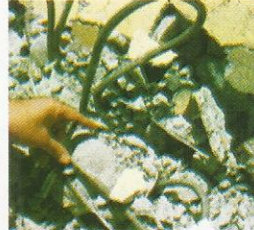
Depremde Yıkılan Bir yapıda Beton Kalitesi ve karışım
